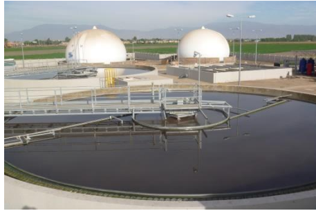
WWTP Compañías Cerveceras Unidas
